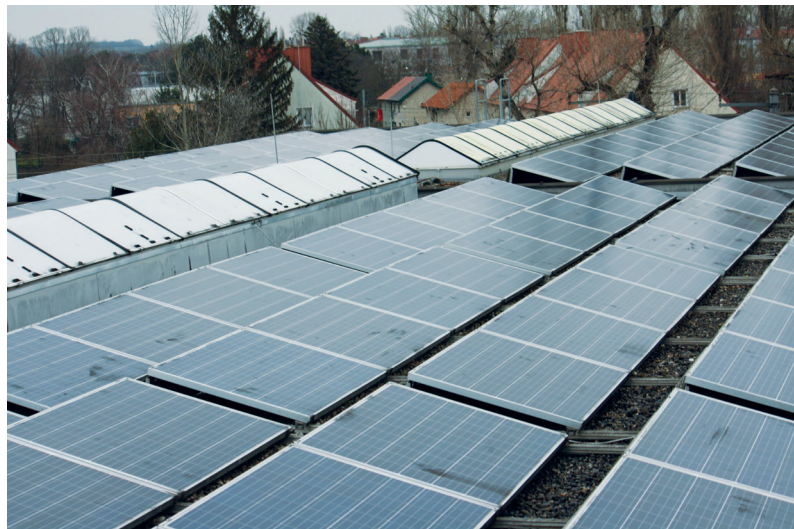
Die aktuelle Photovoltaikanlage wird weiter ausgebaut
